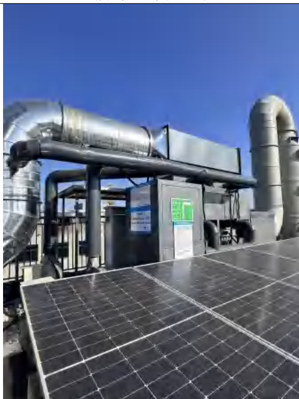
胶水废气、印刷废气（水喷淋+干式过滤器+活性炭吸附-脱附+催化燃烧）废气治理设施照片
