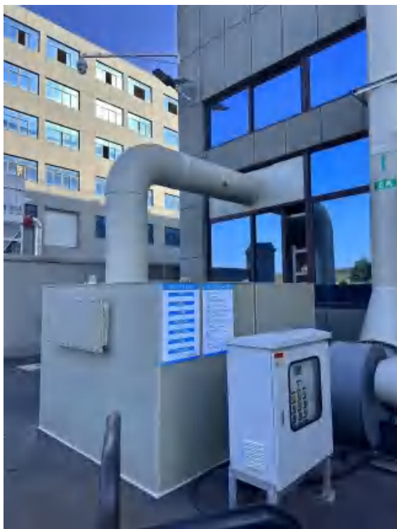
注塑废气（二级活性炭吸附）废气治理设施照片
