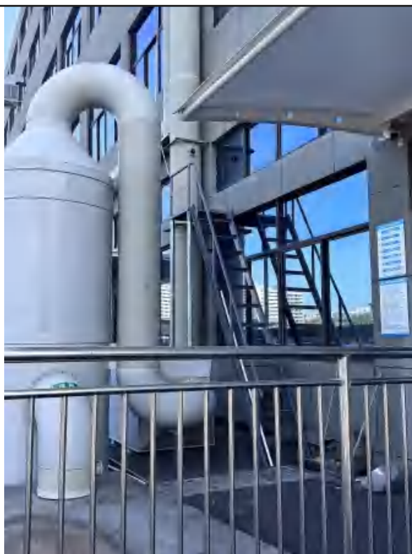
环氧乙烷灭菌废气（水喷淋吸收+活性炭吸附）废气治理设施照片
