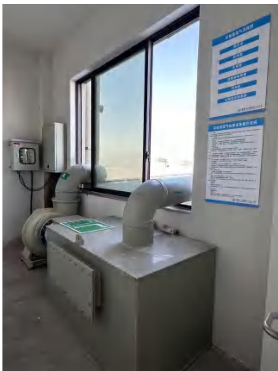
实验室废气（活性炭吸附）废气治理设施照片
